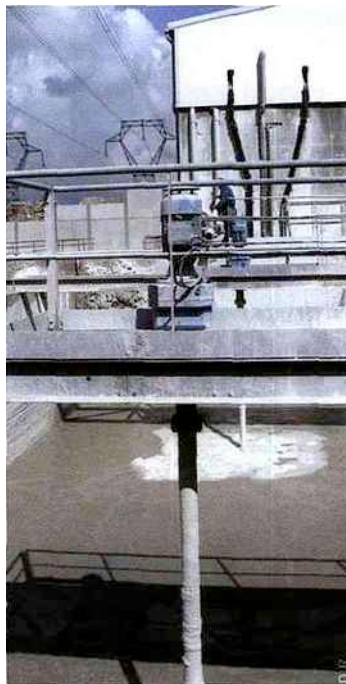
Bassin d'eaux sales avant leur passage en filtre-pressé
